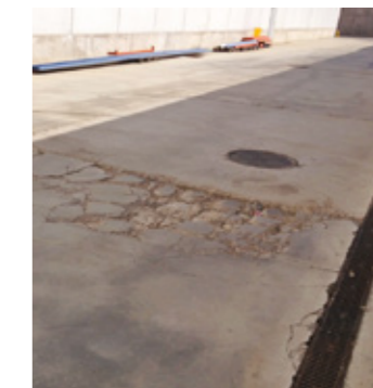
Losa de hormigón deteriorada antes de su reparación
